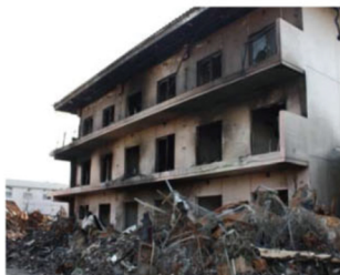
東日本大震災、津波火災の後
